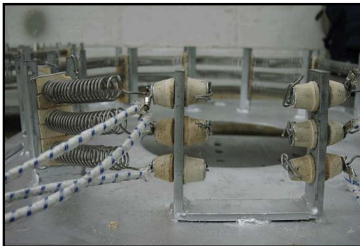
Figura # 9, Detalle de las resistencias.
