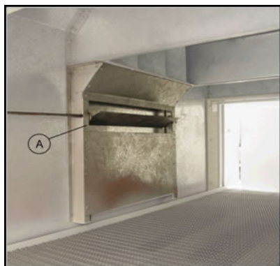
Figura # 4, Alerones del Túnel de termocontracción.
